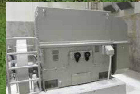
発電機電圧は配電線と同じ6.6kV定格とし、主変圧器を省略
