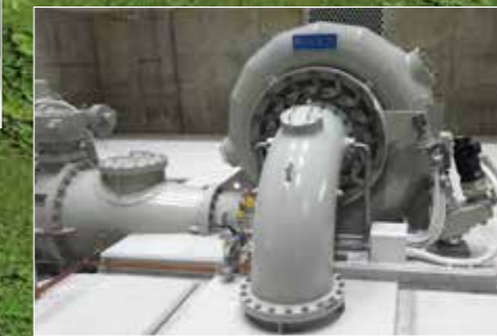
河川流量が変化しても高い効率で発電が可能なフランシス水車を採用
