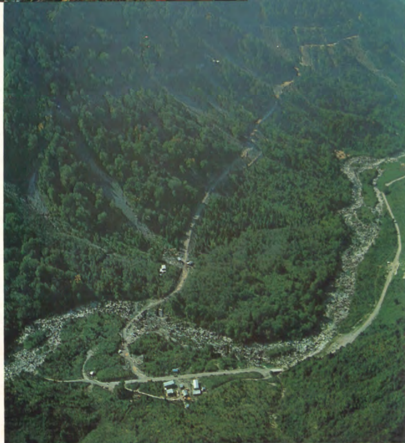
富山-桂台-美女平へ、そして室堂へ 車に乗ったまま行ける道路の建設現場
