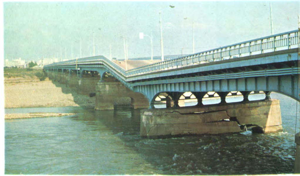
▲ 昨年7月の長雨で沈下した富山大橋 国道8号線の渋滞に拍車をかけました
