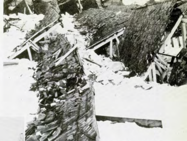
雪の重みに耐えかね倉庫は無残にも押しつぶされた
