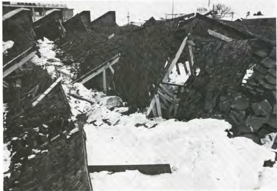
▼56年豪雪は生活 産業にも大きな被害をもたらした(写真は押しつぶされた工場の倉庫)
