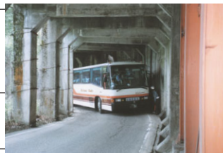
富山県で初めて設置されたスノーシート (県道庄川河合線旧利賀村栗当地内)
