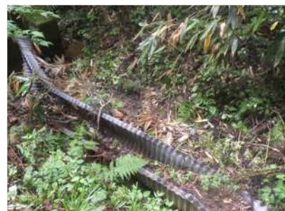
中尾地区(コルゲート水路の破損)
