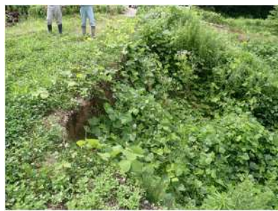
蛇下地区(R5.7線状降水帯による道路の陥没、沈下)
