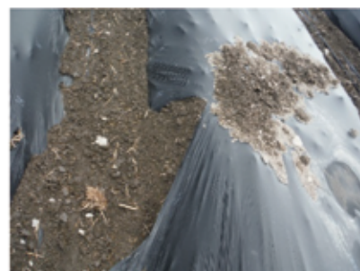
写真1 ローラー跡の裂け
