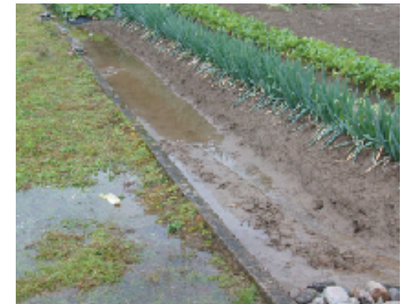
周辺農業地への漏水例
