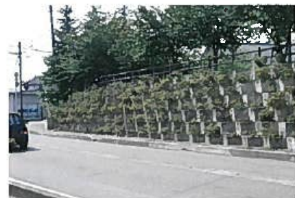
擁壁に低木が植栽可能な構造とし、擁壁の圧迫感を軽減し、うるおいを創出している。(大島町)
