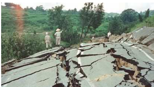
◆国道359号が約1km崩壊
