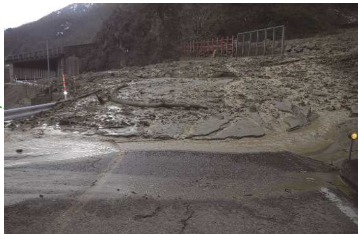
◆利賀村新山地内 南砺市/平成30年(2018年)4月 土砂流出により国道156号が被災。
