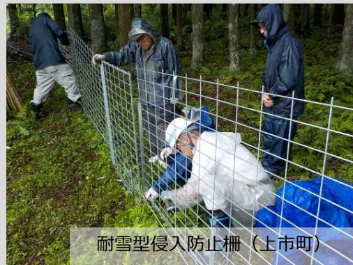
耐雪型侵入防止柵 (小矢部市)
