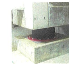
免震装置 (積層ゴム)
