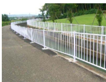
縦型防護柵(H=1.10m)
