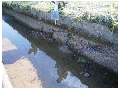
老朽化した農業用水路の状況(富山市内)
