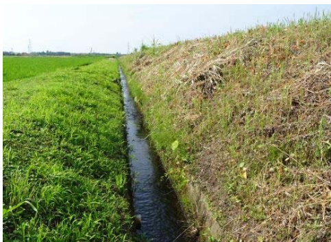
浸食土砂により水路天端が消失
