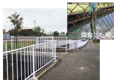
老朽化した柵の更新状況
