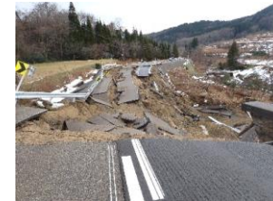
崩落した国道359号（小矢部市）
