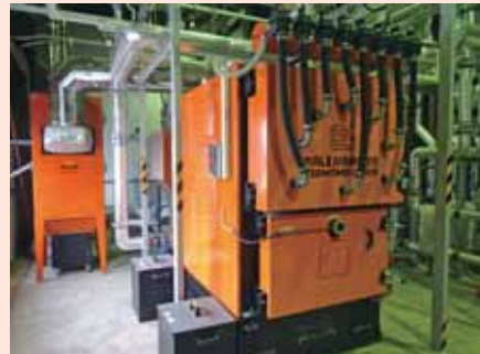
福光プールのバイオマスボイラー(2017年2月整備)
