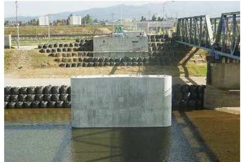
アルカスコーポレーション(株)施工の「一般県道安居福野線 道路総合交付金（防災・架替）川崎橋下部工（P2橋脚）工事」
