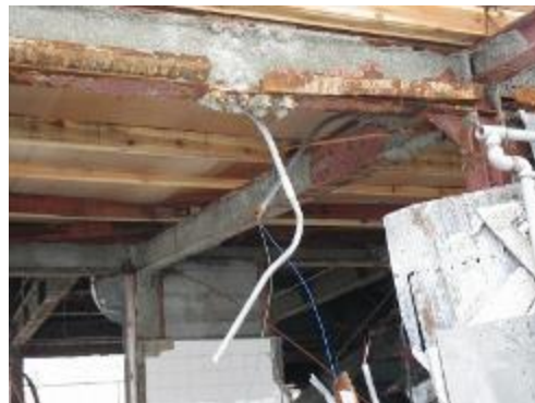
建物に残存した吹付け材
