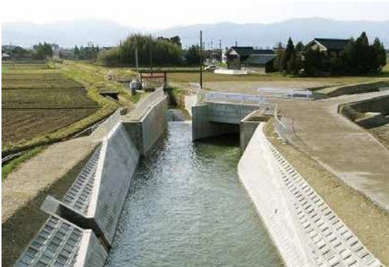
北陸ハイウェイ建設(株)施工の「農地防災庄川左岸三期地区海尻川排水路第1工区工事」
