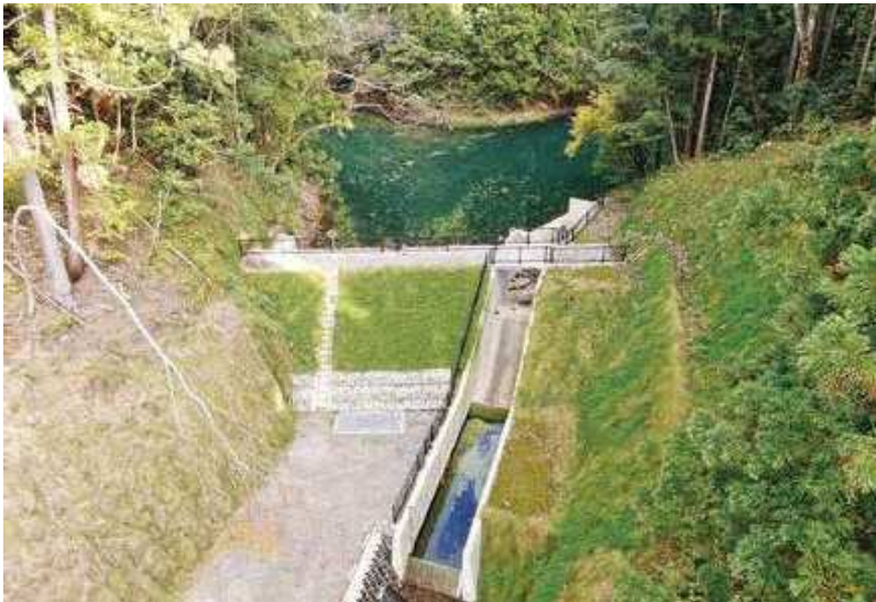
(株)森長組施工の「県営農村地域防災減災事業双子池地区双子池堤体改修工事」
