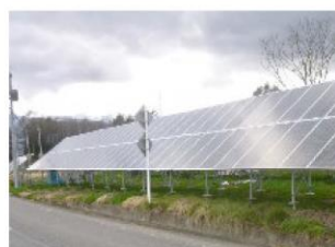
柵塀の設置されない設備
