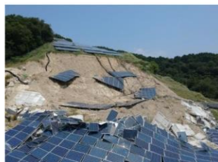
土砂崩れで生じた崩落
