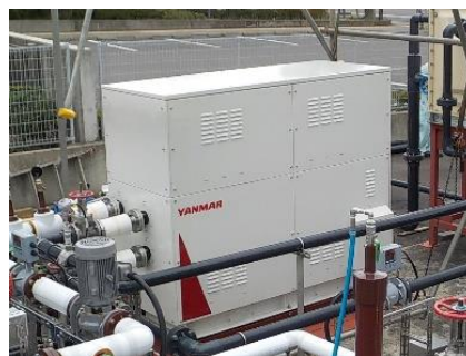
図 2-18 温泉排熱を利用した小型発電システム
