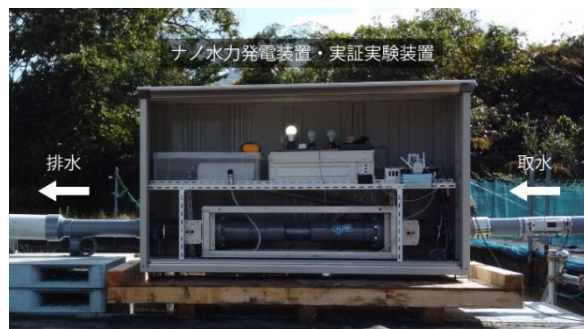
図 2-17 金沢工業大学等が実証しているナノ水力発電設備
