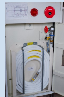
一人で操作できる屋内消火栓
