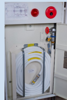
一人で操作できる屋内消火栓
