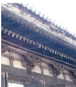
軒廻りの劣化状況
