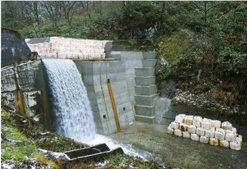
(株)池田組施工の「庄川圏域梨谷川砂防総合交付金（砂防）緊急改築堰堤工工事」
