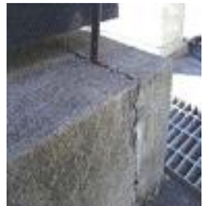
広告物の基礎の劣化 によるひび割れ
