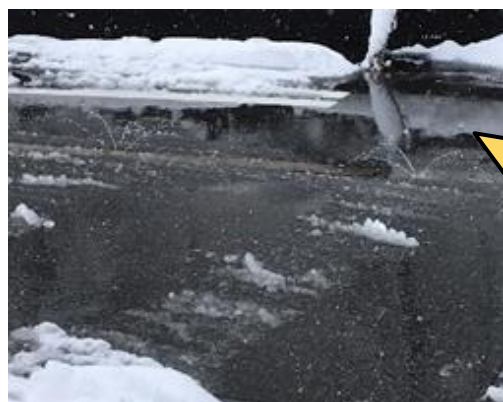
地下水を利用した消雪設備
