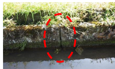
用水路劣化状況(目地欠損)
