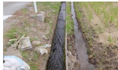
用排水路からの漏水状況
