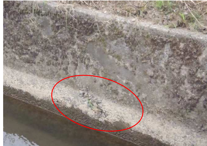
用水路の劣化状況
