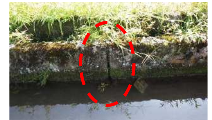
用水路劣化状況(目地欠損)
