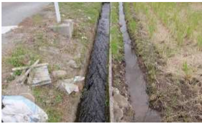
用排水路からの漏水状況
