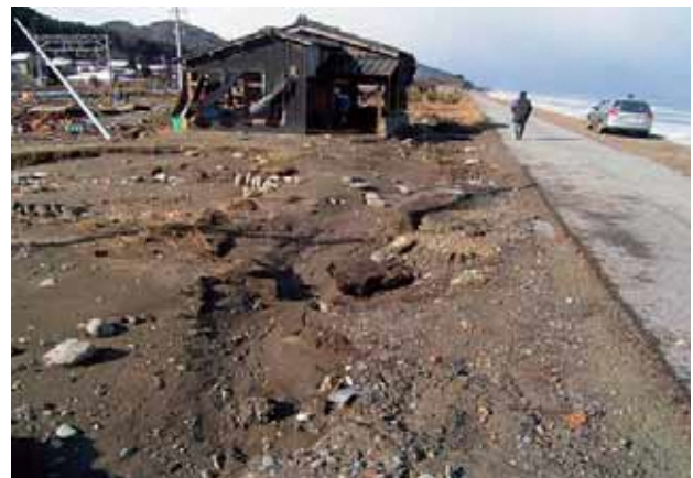
越波後の被害状況 [朝日町境海岸]
