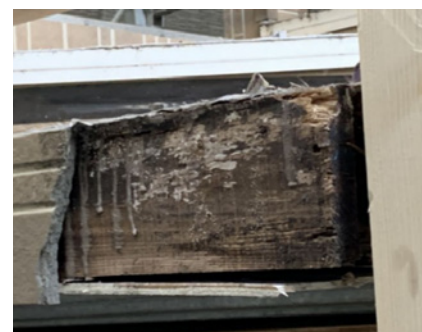
木造階段の外装材料の欠損と木材の腐朽 (出典元：木造の屋外階段等の防腐蚀置等ガイドライン事例集)
