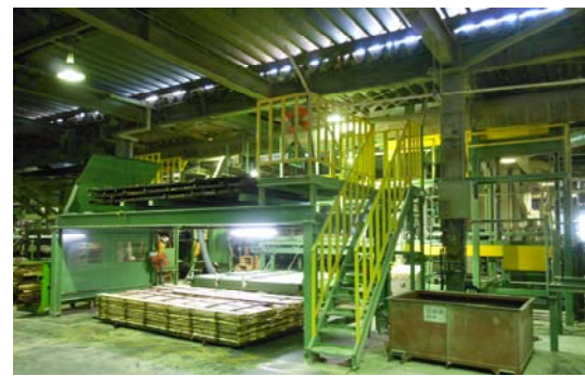
再生基金により整備した木材加工施設
