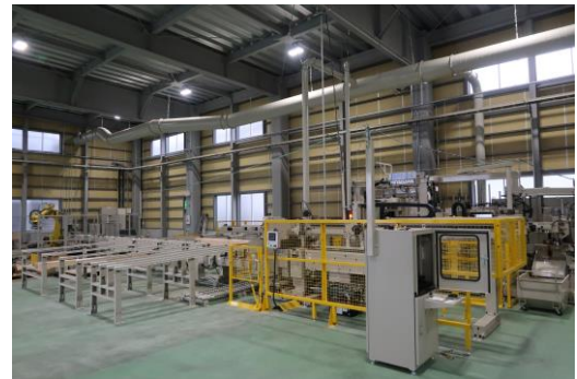
木材加工流通施設への機械導入 (プレカット加工機)
