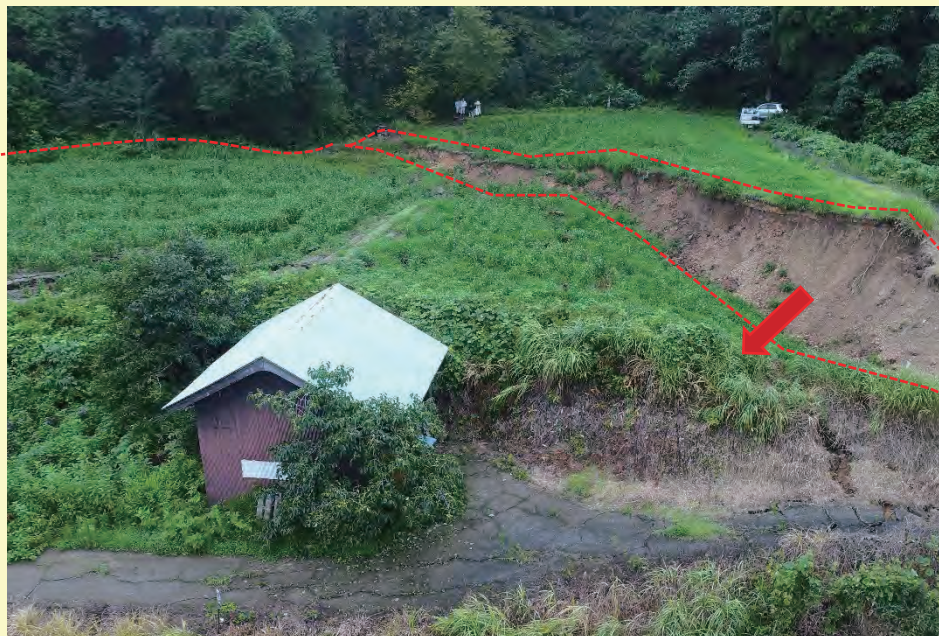
農地の被災状況（地すべりブロック冠頭部）
