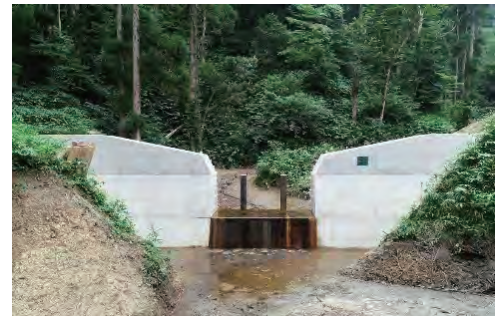
流木捕捉機能を備えた治山ダム (高岡市加茂)
