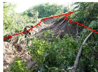
長川原地区 (R5.5豪雨による山腹崩壊)
