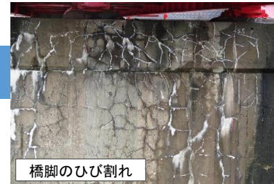
橋脚のひび割れ 橋梁の老朽化対策 (県道高岡小杉線 南郷大橋の損傷状況)
