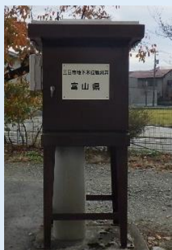
無線通信技術を活用して テレメータ化した観測井
