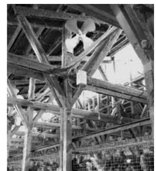
鶏舎に設置した送風機の例
