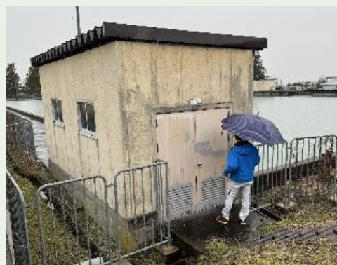
減圧弁室（ファームボンド）
