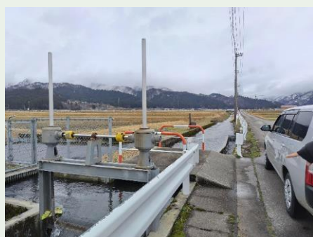
放水地点付近
