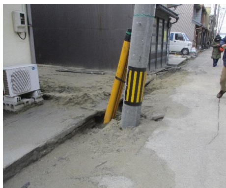
液状化（令和6年1月11日射水市港町）
