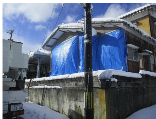
破損建物（令和6年1月25日小矢部市植生）
