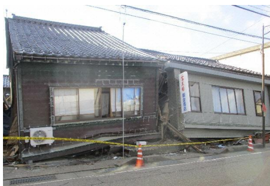
倒壊建物（令和6年1月10日氷見市北大町）
