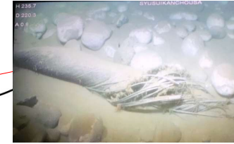
海洋深層水取水管断絶（入善町）
