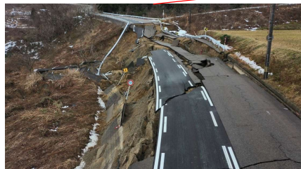
崩落した国道359号（小矢部市）
