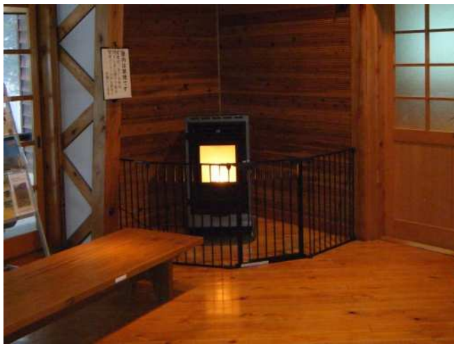
ペレットストーブ（県林業普及センター）
