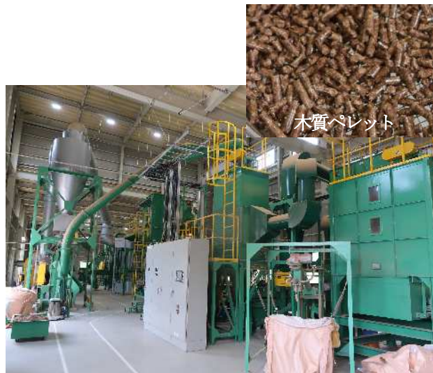
木質ペレット製造施設（南砺市）
