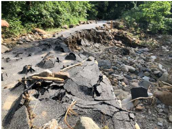
増水による林道の路体流出 (R5年6月立山町茨谷線)
