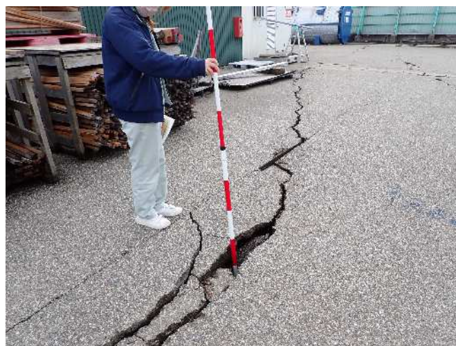
木材加工施設内の舗装破損（氷見市）
