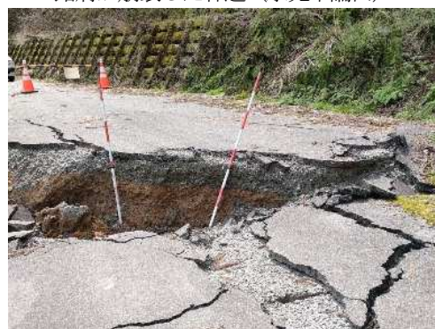
段差が発生した林道（富山市八尾町）
