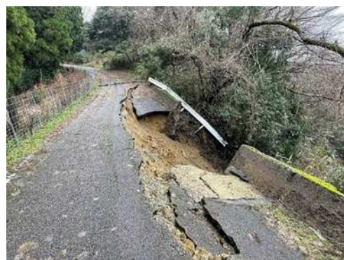
路肩が崩壊した林道（氷見市論田）
