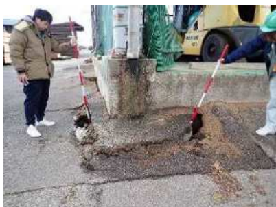
木材加工施設の液状化被害
