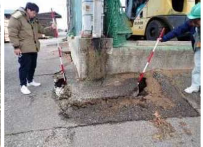
木材加工施設の液状化被害
