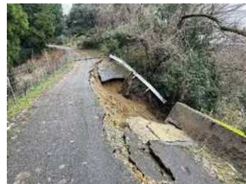
路肩が崩壊した林道
