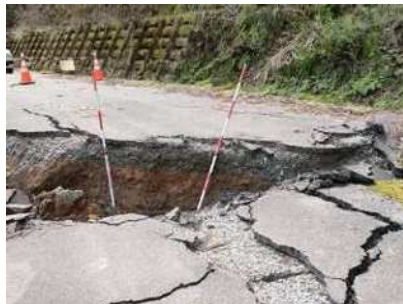
段差が発生した林道
