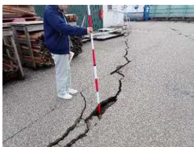
木材加工施設の舗装破損
