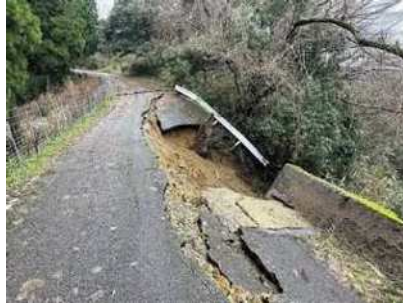
路肩が崩壊した林道
