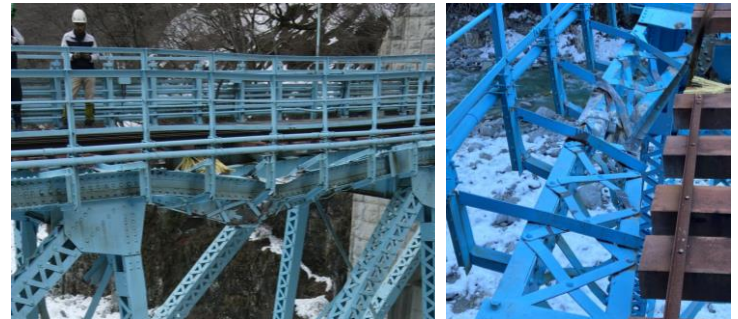
黒部峡谷鉄道 鐘釣橋の落石による被害
