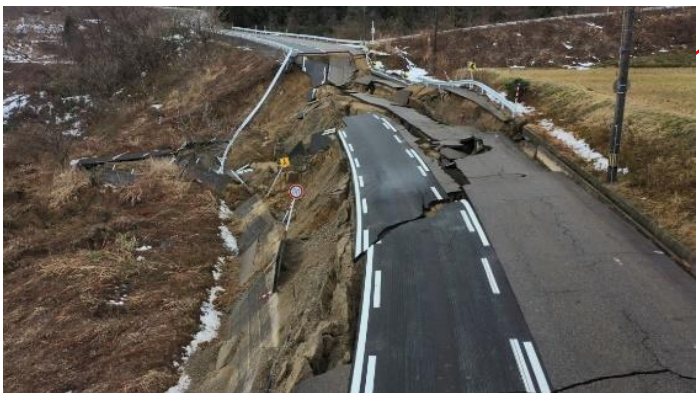
崩落した国道359号（小矢部市）
