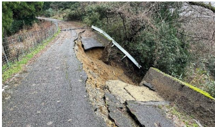
林道の路肩崩壊 (氷見市論田地内)
