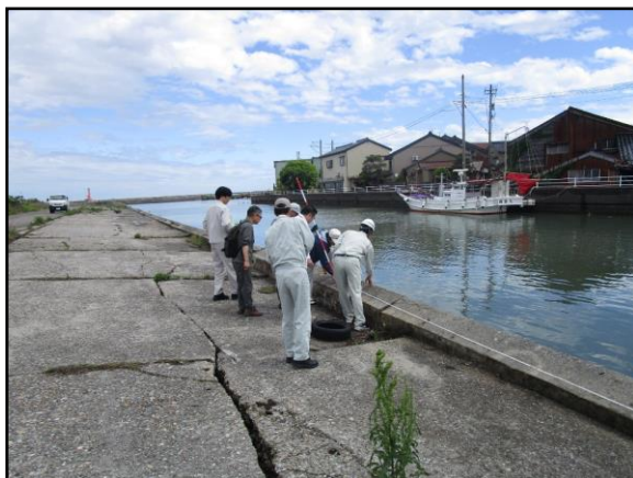
災害査定 伏木富山港（伏木地区）右岸1号物揚場 射水市庄西町
