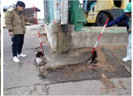
木材加工施設の液状化被害
