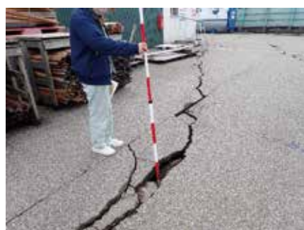
木材加工施設の舗装破損
