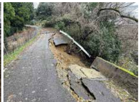
路肩が崩壊した林道
