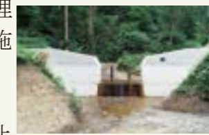
流木捕捉機能ダム
