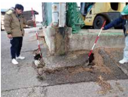
木材加工施設の液状化被害
