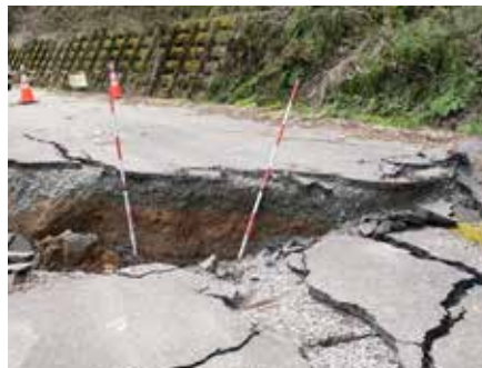
段差が発生した林道
