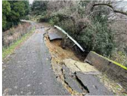
路肩が崩壊した林道
