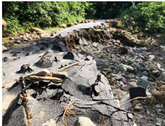
増水による林道の路体流出 (R5年6月立山町茨谷線)
