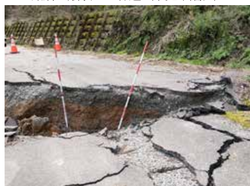
段差が発生した林道（富山市八尾町）
