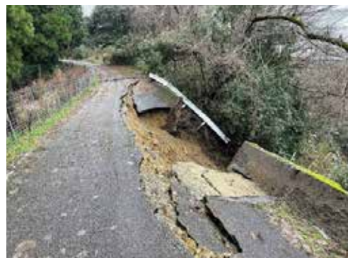
路肩が崩壊した林道（氷見市論田）
