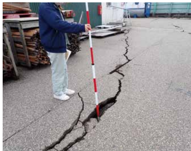
木材加工施設内の舗装破損（氷見市）
