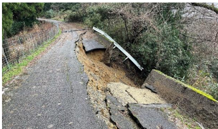
林道の路肩崩壊 (氷見市論田地内)
