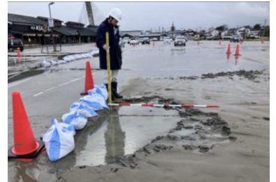
ひみ番屋街駐車場の液状化
