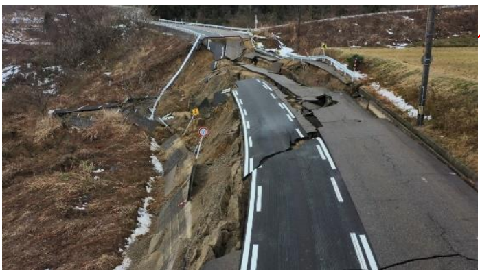
崩落した国道359号（小矢部市）
