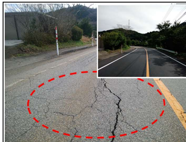
施設の復旧状況 一般国道415号 氷見市熊無
