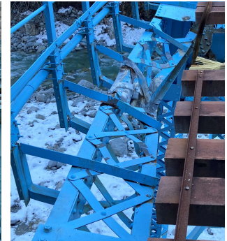
鐘釣橋の落石による被害
