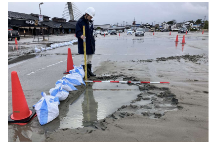
ひみ番屋街駐車場の液状化
