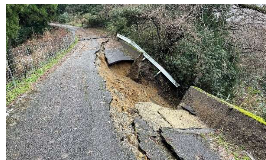
林道の路肩崩壊 (氷見市論田地内)
