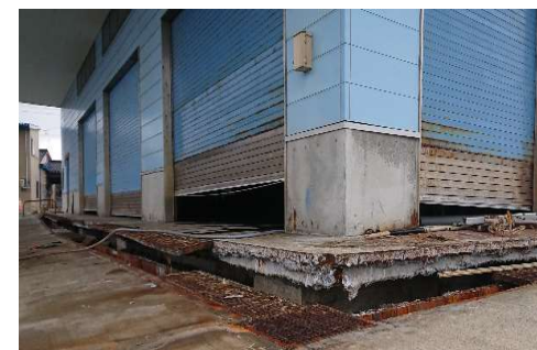
荷さばき施設被害状況 (富山市水橋漁港)
