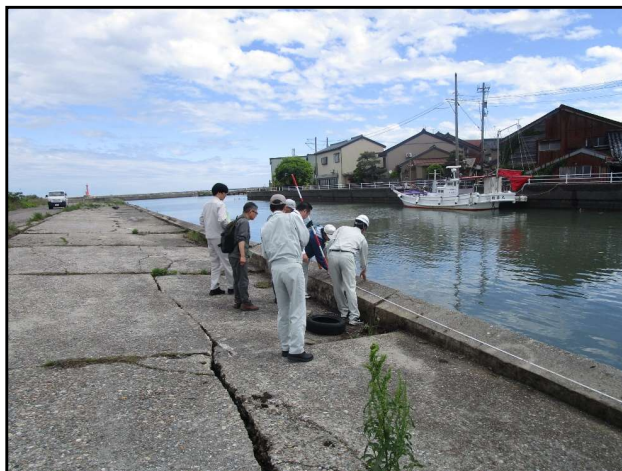
災害査定 伏木富山港(伏木地区)右岸1号物揚場 射水市庄西町
