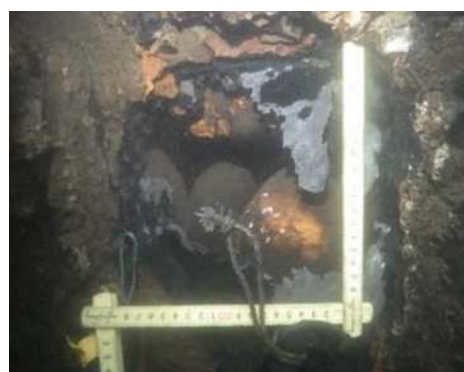
老朽化により腐食が進行した岸壁の鋼矢板
