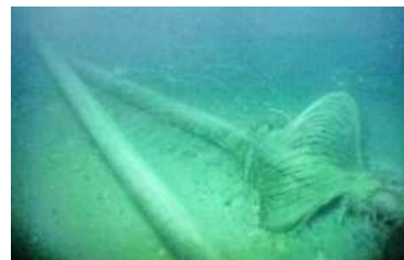
損傷した取水管
