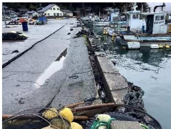
地震による県内漁港の被害
