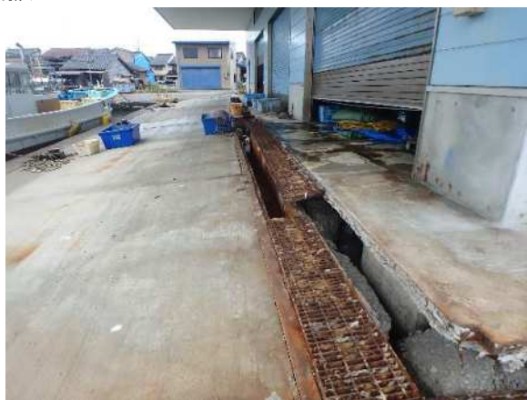
被災した荷捌き施設
