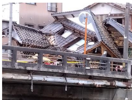
石川県穴水町 民家の被害 (1月5日)
