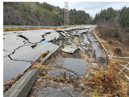
石川県七尾市 道路被害 (1月9日)
