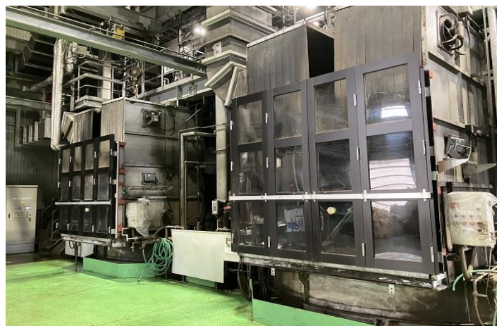
■ 混練処理施設
