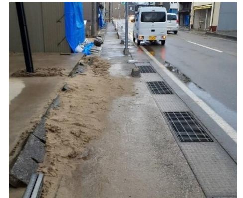
液状化の被害
